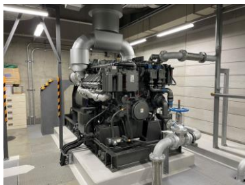
非常用発電機
